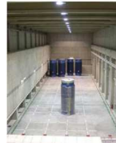
Figure 46 : Photo intérieure d'un bâtiment d'entreposage de type « WTI/GNS »
