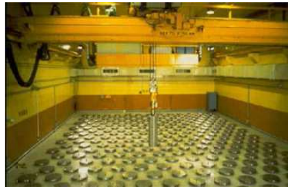
Figure 58 : Photo de la cellule de déchargement et de manutention de l'installation CASCAD du CEA/Cadarache
