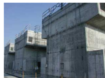
Figure 26 : Photo de l'entreposage DICA de type MACSTOR® à Cernavoda (Roumanie)
