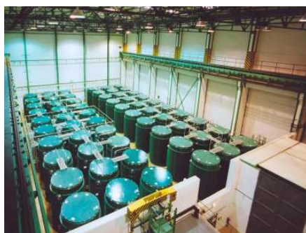
Figure 53 : Entrepôt en emballages CASTOR® sur le site de la centrale de Dukovany (Rép. Tchèque)
