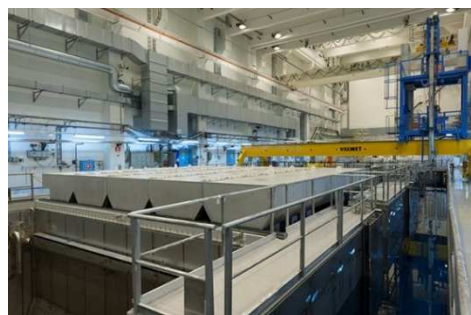
Figure 9 : Photo de la piscine d’entreposage dénommée TVO-KPA-STORE (site d’Olkiluoto - Finlande)
