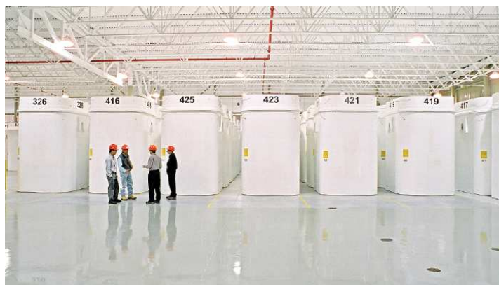
Figure 56 : Photo d'un entreposage en emballages béton développés par la société OPG
