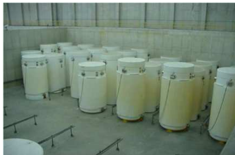
Figure 40 : Photo de TN ® 24 DH entreposés dans le bâtiment d'entreposage à sec du site de Doel (Belgique)
